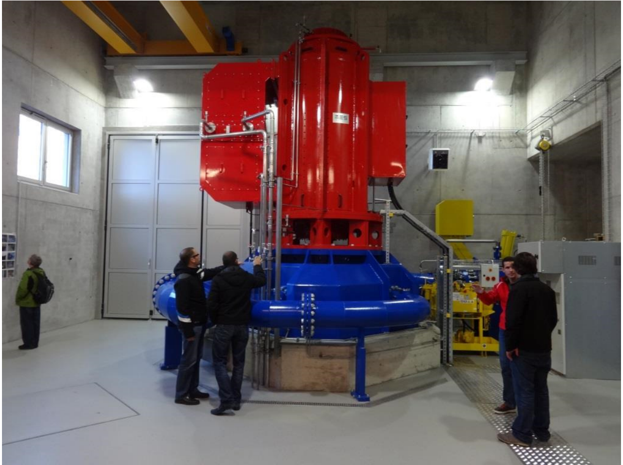
Maschinengruppe in der Zentrale Ulrichen
